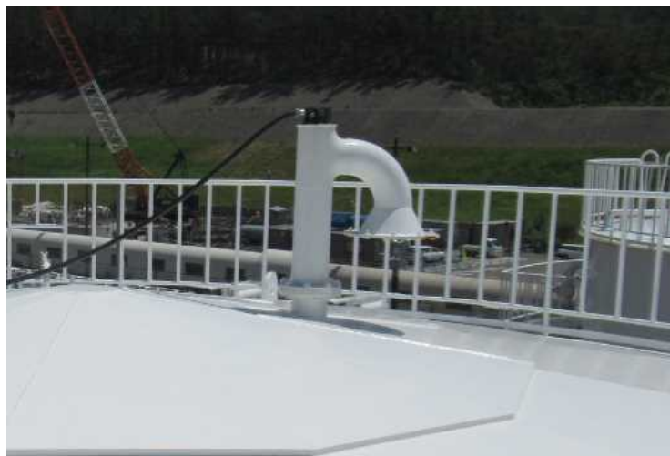
図 6-3 軽油タンクの通気口
