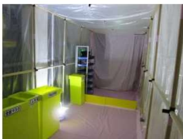
可搬型照明①
