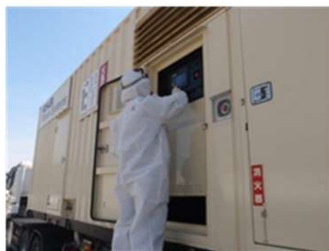
可搬型代替電源車起動 (屋外)
