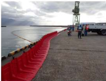
荷揚場シルトフェンス設置状況 （赤の遮水壁：ボックスウォール） （屋外）
