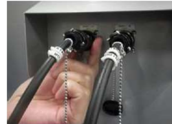
検出器用ケーブル接続
