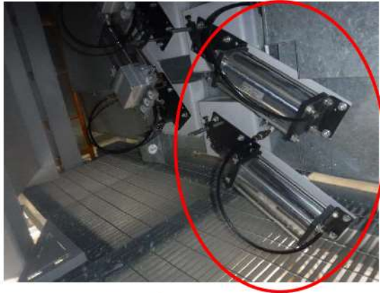
ダンパ全景 (原子炉補助建屋T.P. 40.3 m)
