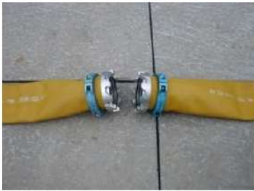
可搬型ホース(150A)接続前
