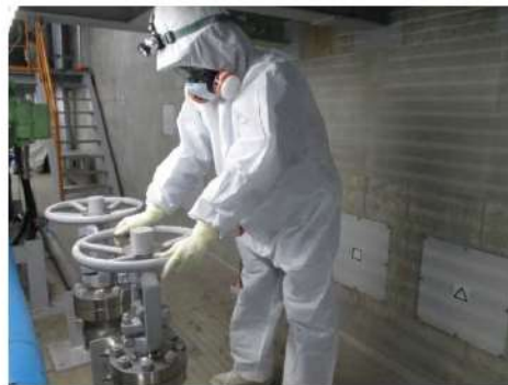
可搬型大型送水ポンプ車による 蒸気発生器への注水系統構成 (周辺補機棟 T.P. 29. 3m)
