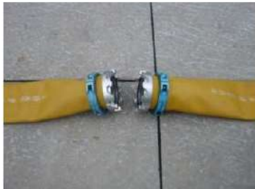
可搬型ホース (150A) 接続前
