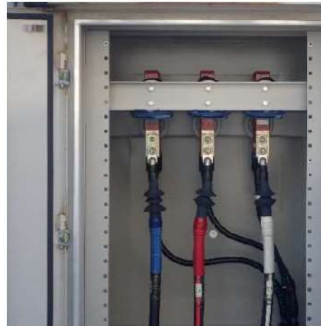
ボルト・ネジ接続 (代替交流電源)
