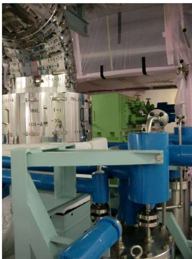
余熱除去ポンプ 外観
