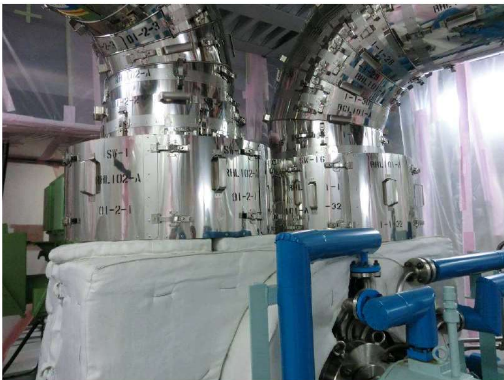
余熱除去ポンプ 配管周辺部
