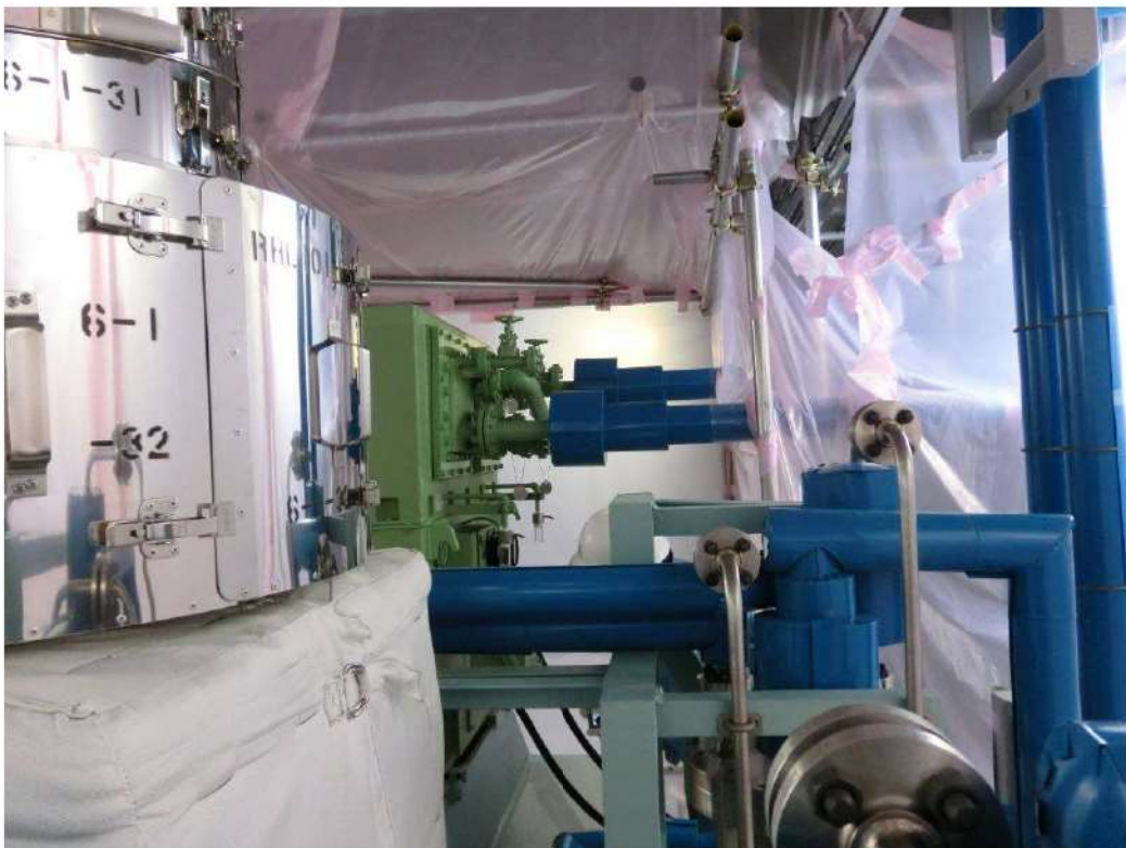
余熱除去ポンプ 周辺状況
