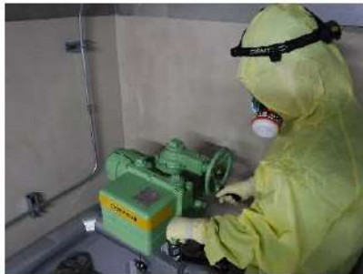
【図3 3B-1次冷却材ポンプ封水注入ラインC/V外側隔離弁操作風景】
