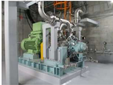
【図7 代替格納容器スプレィポンプ】
