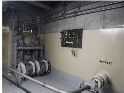
【図4 加圧器逃がし弁操作可搬型窒素ガスポンペ】
