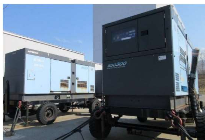
図4-11 緊急時対策所用発電機 外観
