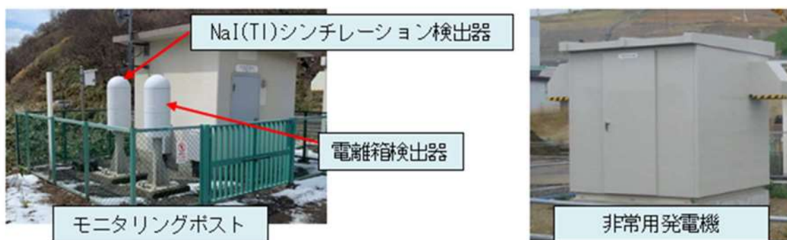
第1.1.4図 モニタリングポストの設置状況
