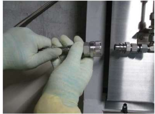
アニュラス全量排気弁等操作用可搬型 窒素ガスポンベのカプラ接続 (周辺補機棟 T.P. 40. 3m)
