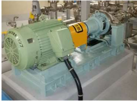
ポンプ，配管，支持構造物の例
