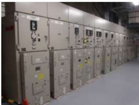
第 41-1-27 図：3A-安全補機開閉器室の状況
