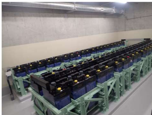
第 41-1-28 図：常用系蓄電池室の状況
