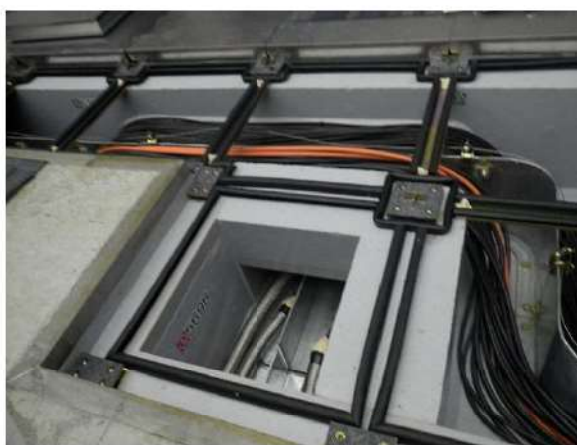
第 41-1-26 図：フロアケーブルダクトの状況
