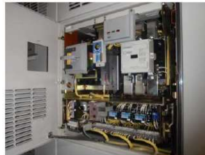
パワーコントロールセンタ
