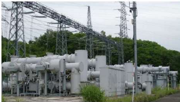
西野変電所（GIS）
