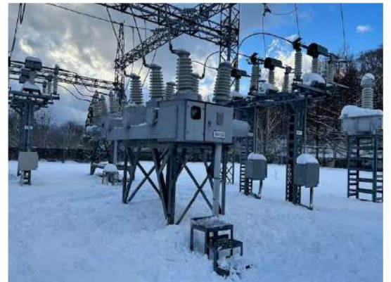
国富変電所（VCB）
