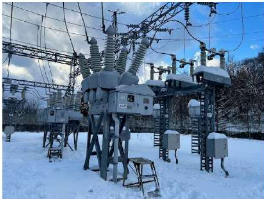
国富変電所（GCB）
