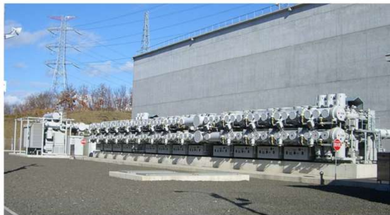
第 2.2.4.6 図 開閉所設備外観
