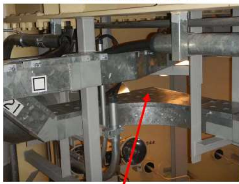
金属製の蓋が設置されたケーブルトレイ
