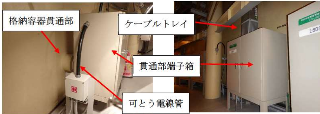
機器へのケーブル取合い状況 (格納容器貫通部とケーブルトレイ・電線管との取合い)
