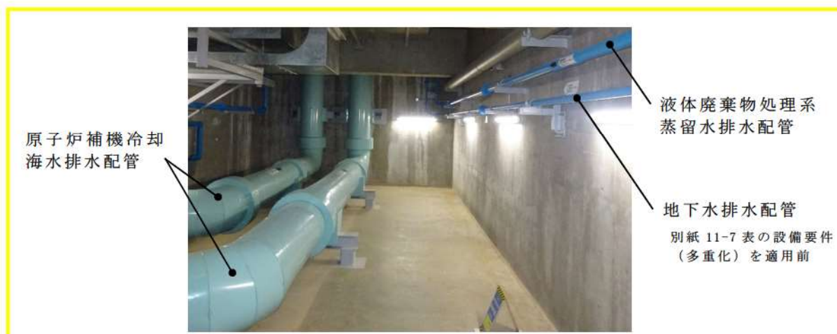
添付 7-6 図 地下水排水配管写真（電気建屋）
