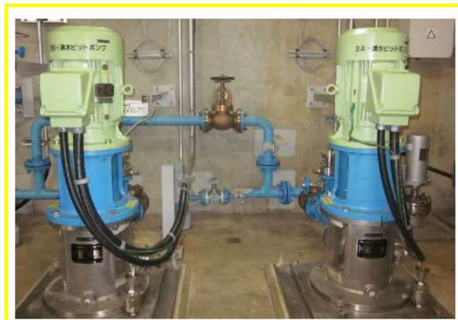
添付 7-5 図 湧水ピットポンプ写真
