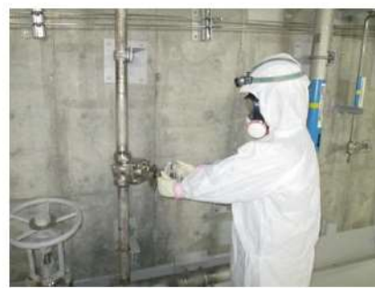
可搬型大型送水ポンプ車による原子炉格納容器下部への注水系統構成 （運転員（現場）C） （周辺補機棟 T. P. 10. 3m）
