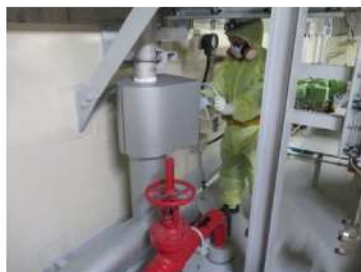
可搬型大型送水ポンプ車による 原子炉容器への注水 系統構成 (運転員 (現場) B) (原子炉補助建屋 T.P. 10.3m)
