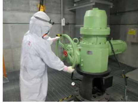
主給水隔離弁閉止操作 (周辺補機棟 T. P. 29. 3m)
