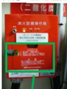
写真⑤ 消火設備操作箱
