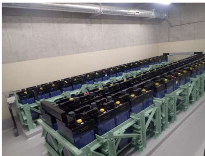
第 1-29 図：安全系蓄電池室の状況
