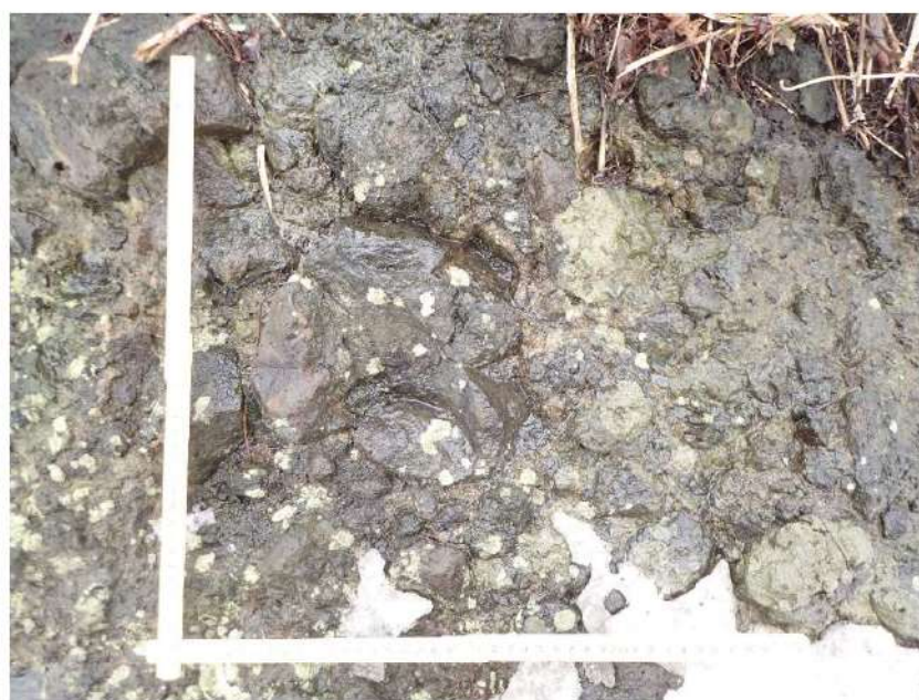
図 2.1.a.c-4 (18) 防潮堤（茶津側）露頭状況 P18 茶津川沿いの地山斜面下部（P17 拡大） 凝灰角礫岩が分布し、B 級からなる。
