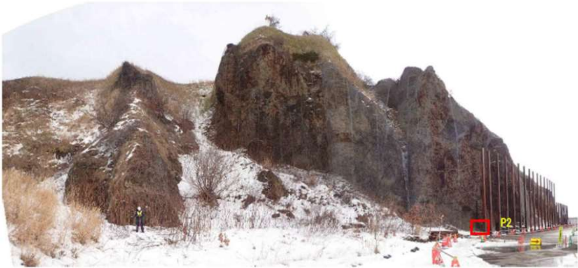
図 2.1.a.c-7 (1) 防潮堤（堀株側）露頭状況 P1 防潮堤擦り付け部全景 露頭全面に凝灰角礫岩が分布する。
