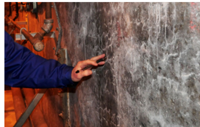
ASR（遅延膨張性）の発生状況例※4
