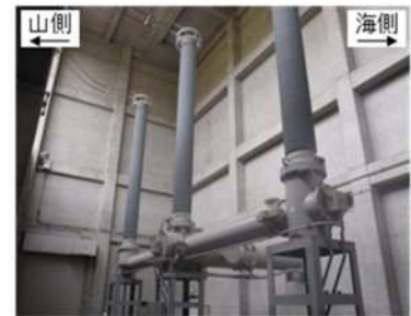
ポリマー碍管 (遮風建屋内)
