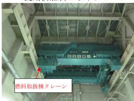
燃料取扱棟クレーン
