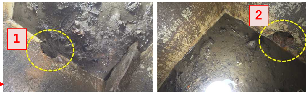
(2) ピット近傍のマンホール内の状況 (黄丸はマンホール内で確認された穴)
