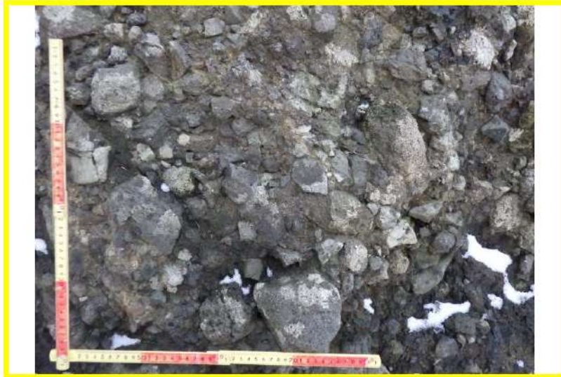
図 2.1.a.c-4 (11) 防潮堤（茶津側）露頭状況 P11 岬の近景（山側）(P10 拡大) 凝灰角礫岩が分布し、C級からなる。
