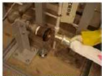
⑤ 可搬型ホース～使用済燃料ピット補給用冷却配管 接続前
