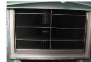
装置底部 (PAR入口給気口)
