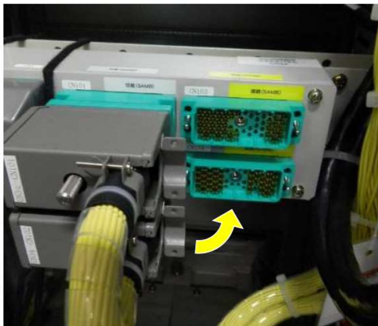
(1次系制御監視盤内 切替器)
