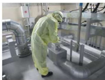
可搬型大型送水ポンプ車による 原子炉容器への注水 系統構成 (運転員 (現場) B) (原子炉補助建屋 T.P. 10.3m (中間床))
