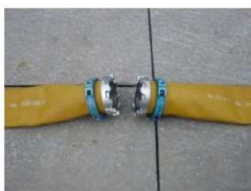
可搬型ホース(150A) 接続前
