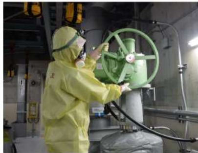
余熱除去ポンプ RWSP 側入口弁及び余熱除去ポンプ RWSP/再循環サンプ側入口弁手動操作 (原子炉補助建屋 T. P. 2. 8m)
