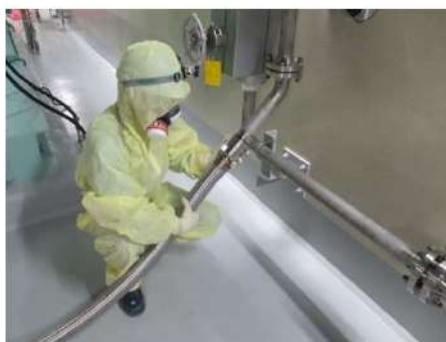
自己冷却水用可搬型ホース接続 （原子炉補助建屋 T.P. -1.7m）
