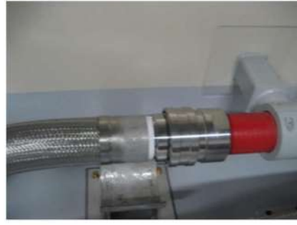
消火水系配管と 格納容器スプレイ系配管との 接続のための可搬型ホース配管接続後 (運転員(現場) B) (原子炉補助建屋 T. P. 10. 3m)
