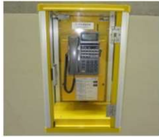
運転指令設備（警報装置を含む）
