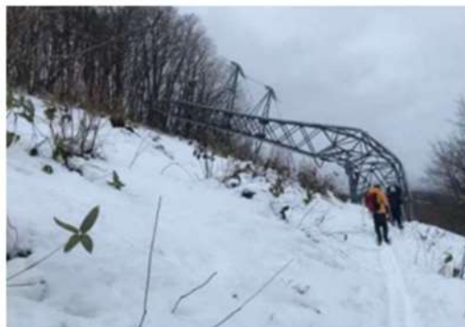
大雪による鉄塔倒壊事例 ※3
