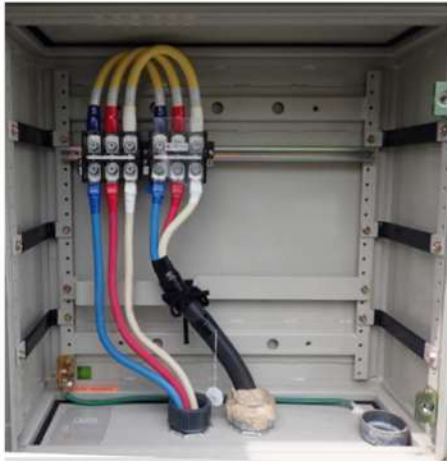
ボルト・ネジ接続 (代替直流電源)
