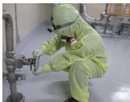
2次系補給水ポンプによる注水 (周辺補機棟 T.P. 10.3m (中間床))
