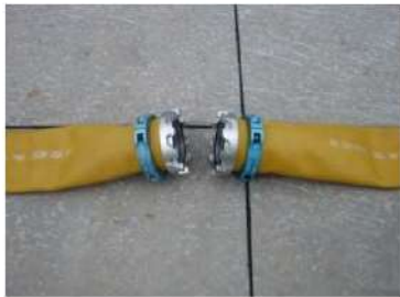
可搬型ホース(150A)接続前
