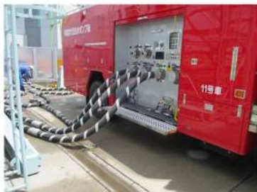
可搬型大型送水ポンプ車の設置 ポンプ車周辺のホース敷設 （屋外）
