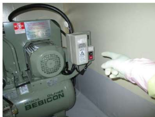
可搬型代替ガスサンプリング圧縮装置起動 (周辺補機棟 T. P. 24. 8m)
