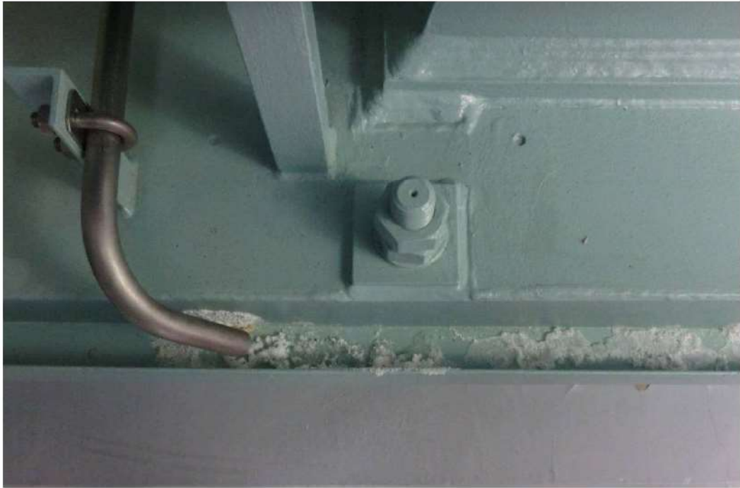
余熱除去ポンプ 据付部
