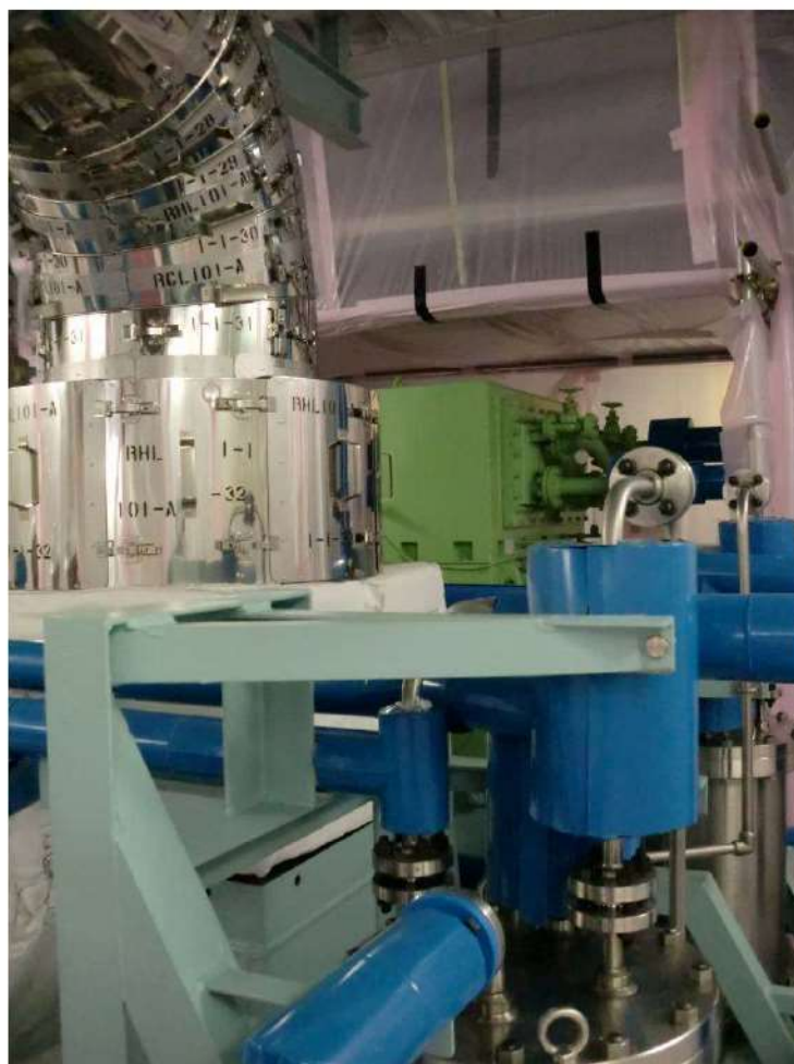
余熱除去ポンプ 外観
