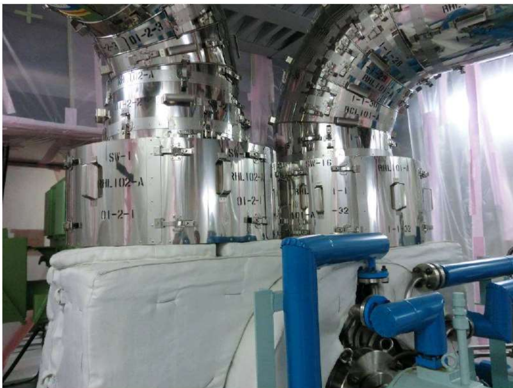
余熱除去ポンプ 配管周辺部
