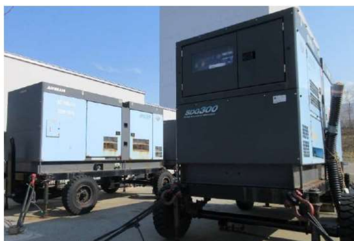
図4-11 緊急時対策所用発電機 外観
