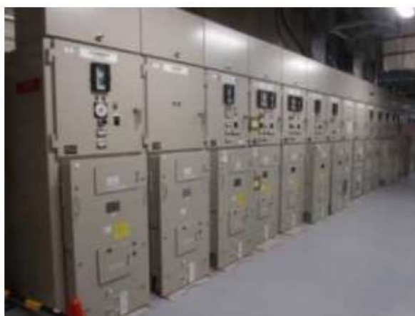
第 41-1-27 図：3A-安全補機開閉器室の状況
