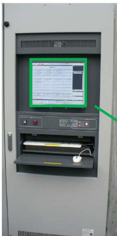
写真④ 中央制御室 総合操作盤
