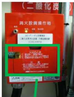
写真⑤ 消火設備操作箱
