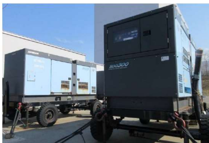
図4-11 緊急時対策所用発電機 外観
