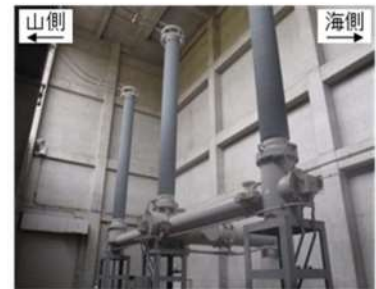
ポリマー碍管 (遮風建屋内)
