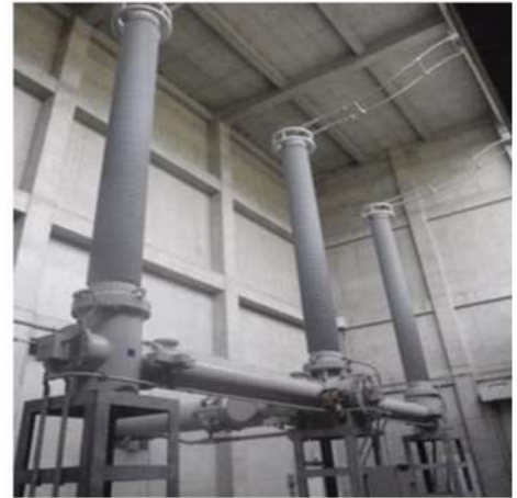
275kV ブッシング
