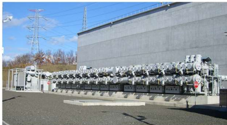
第 2.2.4.6 図 開閉所設備外観
