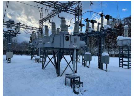
国富変電所（VCB）
