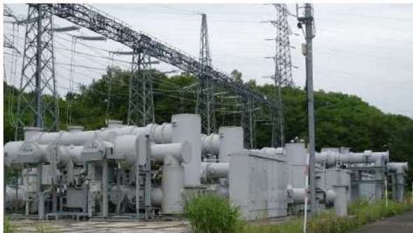
西野変電所（GIS）
