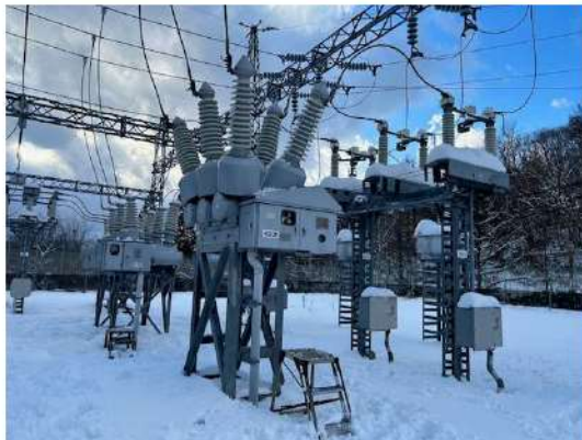
国富変電所（GCB）
