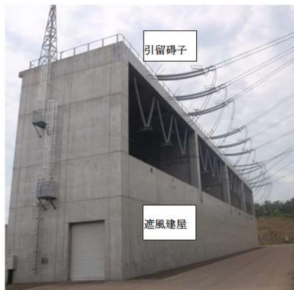
第 5.1 図 275kV 架線部 (引留碍子)
