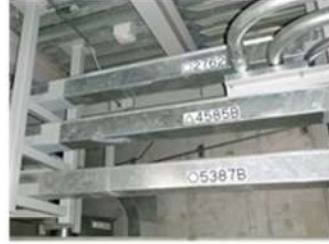
ケーブルトレイ，電線管の例
