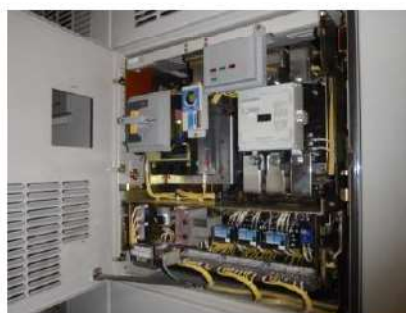
パワーコントロールセンタ
