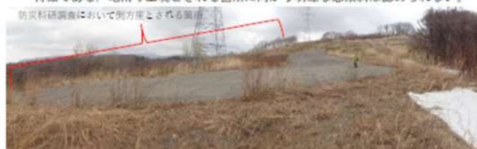
P3 防災科研調査において側方崖とされる斜面の状況 側方崖を示唆する逶急線及び逶緩線は認められない。
