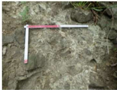
P4 防災科研調査において地滑り土塊末端部とされる箇所の露岩状況 堅硬な岩盤(凝灰角礫岩)が認められる。
