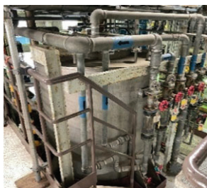
オフガス処理設備 (スクラバ)
