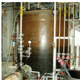
排水処理設備 (廃液槽)
