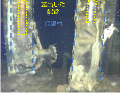
ドレンサンプルピット付近で確認されたRCW配管の保温材の状況（水中）
