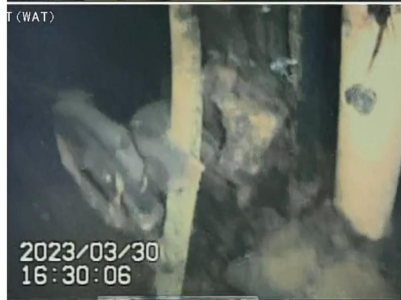
RCW配管の損傷状況
