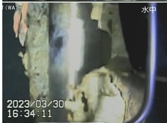
他配管の損傷状況
