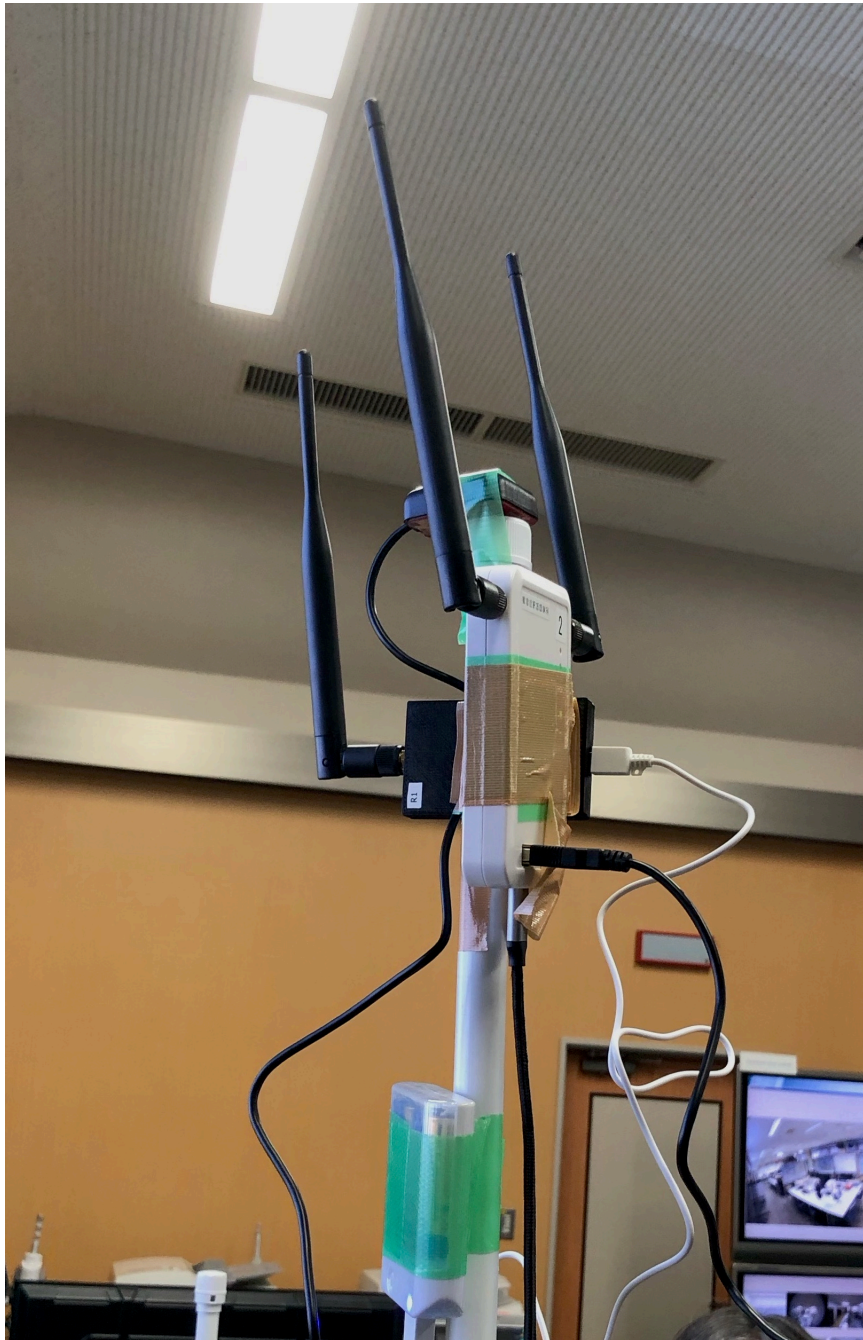
図8 中継局の構成。2.14 dBiの垂直アンテナを1本装備したRouter（黒いケース）と、2.14dBiのアンテナ2本を装備したIoTゲートウェイ（白いケース）が頂点付近に取り付けられている。ポールにはIoTゲートウェイの使用するGPSが取り付けられている。
