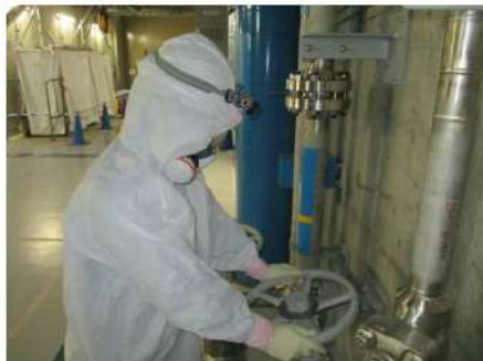
格納容器スプレイから炉心注水への切り替え 系統構成 (周辺補機棟 T.P. 10.3m)
