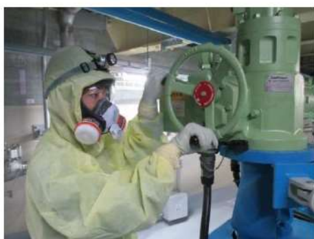
1 次冷却材ポンプ封水ライン隔離弁 閉止操作 （周辺補機棟 T.P. 17.8m（中間床））
