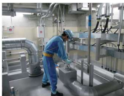
RHRS-CSS 連絡ライン系統構成 (原子炉補助建屋 T.P. 10.3m (中間床))
