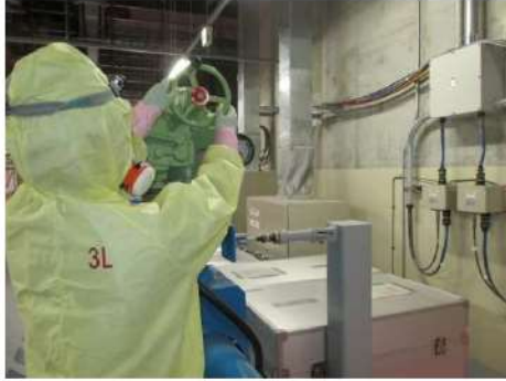
格納容器隔離弁閉止操作 (周辺補機棟 T. P. 24. 8m)
