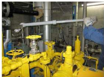
専用工具（蒸気加減弁開操作用）操作 （周辺補機棟 T. P. 10. 3m）
