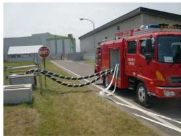
可搬型大型送水ポンプ車の設置 原水槽への吸管挿入 (屋外)
