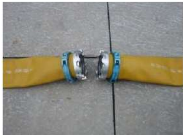
可搬型ホース (150A) 接続前
