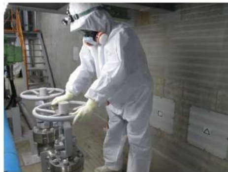
可搬型大型送水ポンプ車による 蒸気発生器への注水系統構成 (周辺補機棟 T.P. 29. 3m)
