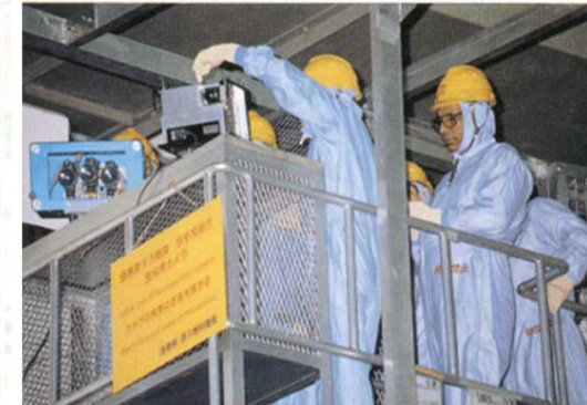
監視装置の保守管理
