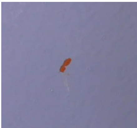
フロー②と判断した塗膜の劣化
