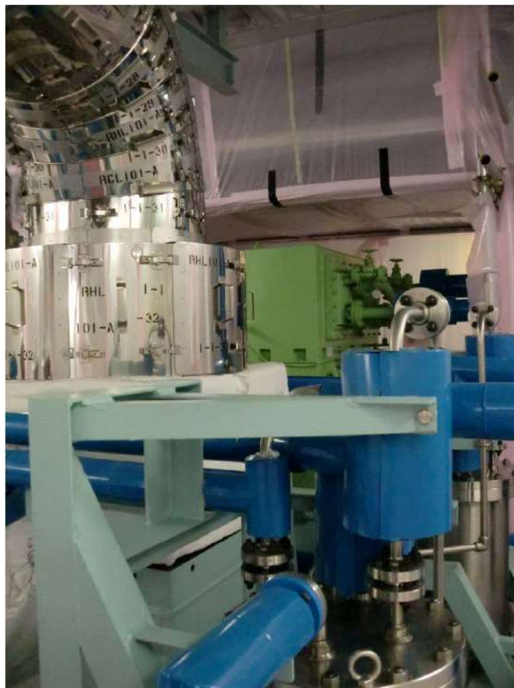
余熱除去ポンプ 外観
